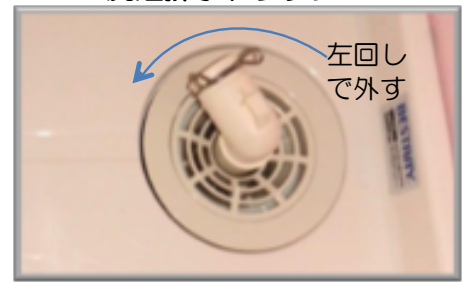
洗濯排水トラップ
